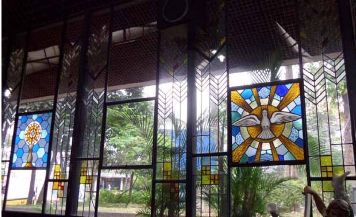
Figura 21 – Fotografia do interior (set/2012). Imagens nos vitrais colocadas posteriormente, sem autorização dos autores do projeto. Fonte: FGVR.
