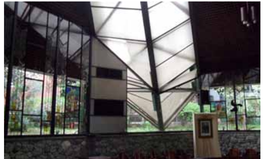
Figura 25 – Fotografia do interior (set/2012). Detalhe das grelhas de ventilação do ar condicionado instalado posteriormente e que comprometem as especificações do projeto original. Fonte: FGVR.
