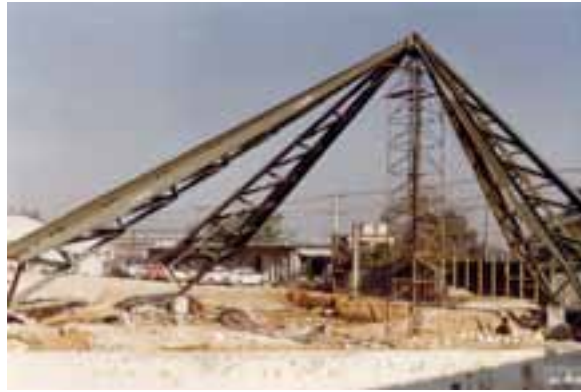
Figura 04 e – Fotografia da montagem da estrutura (jul/1985). A estrutura em pé. Fonte: arquivo do escritório Shieh Arquitetos Associados.
