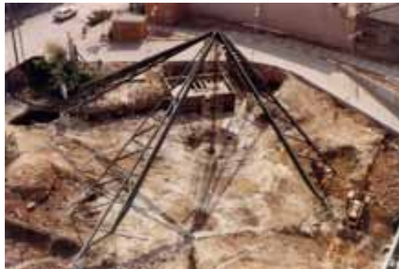
Figura 04 b – Fotografia da montagem da estrutura (jul/1985). As quatro vigas colocadas no local. Fonte: arquivo do escritório Shieh Arquitetos Associados.
