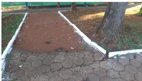
Figura 7. Tipologia dos passeios da Praça Municipal de Coronel Vivida-PR. Fonte: Acervo da(s) Autor(as).
