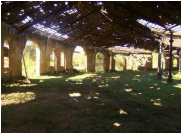
Figura 4 – Vista interna: estado de abandono. Fonte: Fonte: VELOSO, 2015.
