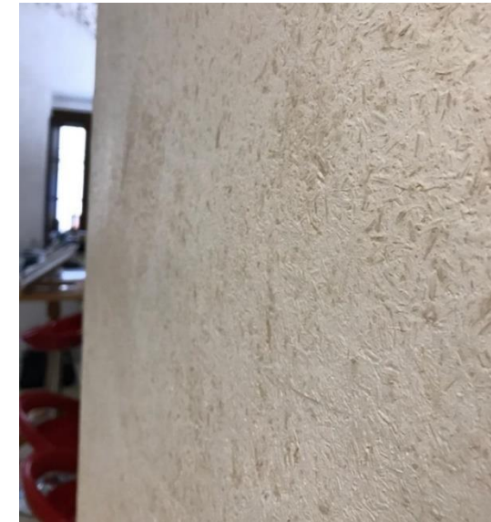
Figura 9. Revestimento das paredes da oficina de tear que possui em sua composição pequenos pedaços de cânhamo. Fonte: Autores, 2019.
