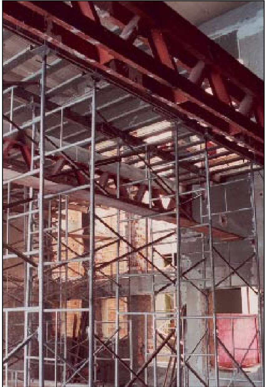
Figura 13 – Montagem de laje pré-moldada sobre estrutura metálica realocada, criando o foyer do auditório no 4º pavimento. Foto: Beto Rodrigues
