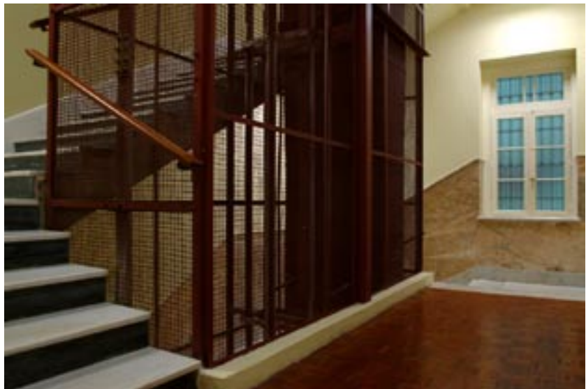
Figura 9 - A escada original do edifício foi transformada em saída de emergência. A caixa de corrida dos elevadores, que ocupava o vazio central da escada, foi aproveitada para instalação do sistema de pressurização contra fumaça. Foto: Del Re + Stein.
